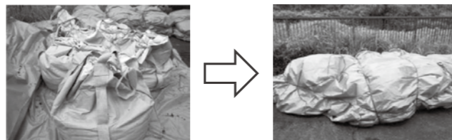
↑ブルーシートの上に並べる(地面に染み込まないように敷いてある) ↑最後にブルーシートをかぶせて雨水が浸入しないようにする
