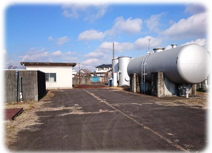
— 志筑野寺浄水場 — (千代田地区)
