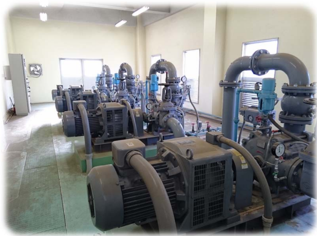
－ 霞ヶ浦浄水場 配水ポンプ － (霞ヶ浦地区)
