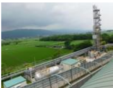
(二酸化炭素分離回収設備)
