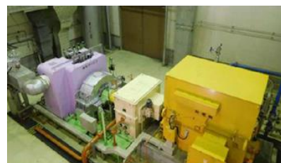
(蒸気タービン発電機)
