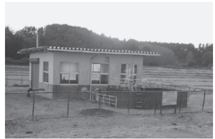
▲排水機場（安食地内）
