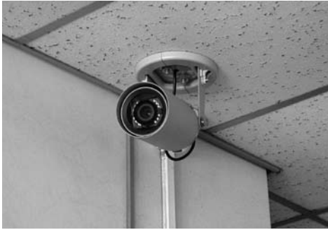
▲学校に設置されている防犯カメラ
