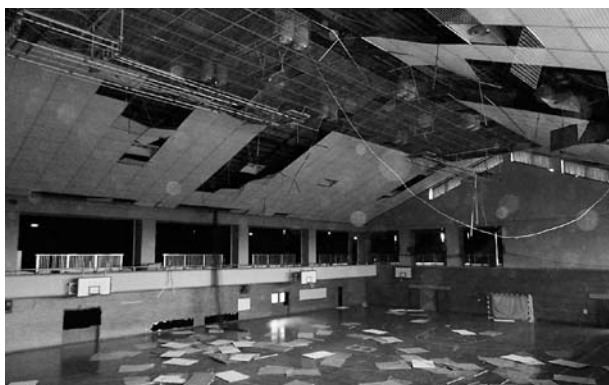
▲千代田中学校体育館の被災状況
