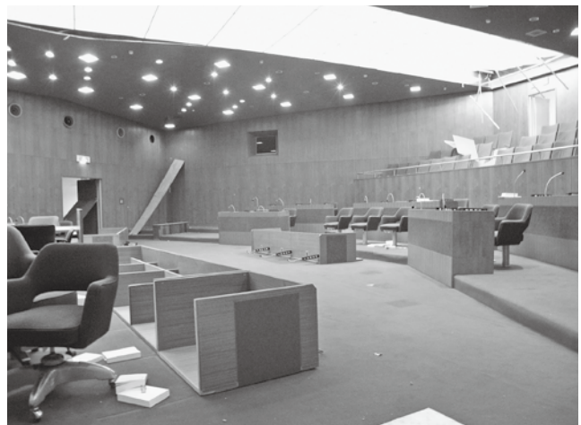
▲被災した議場
