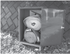
▲消火栓ホース設置の一例 (上土田地内)
