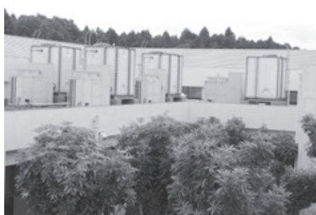
▲老朽化したあじさい館空調の室外機
