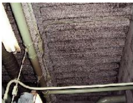
石綿含有吹付けロックウール
