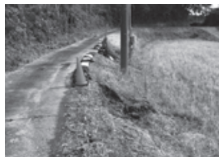
▲大雨により崩れた市道（安食地内）
