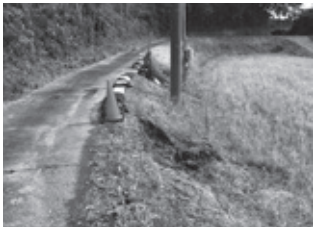
▲大雨により崩れた市道（安食地内）
