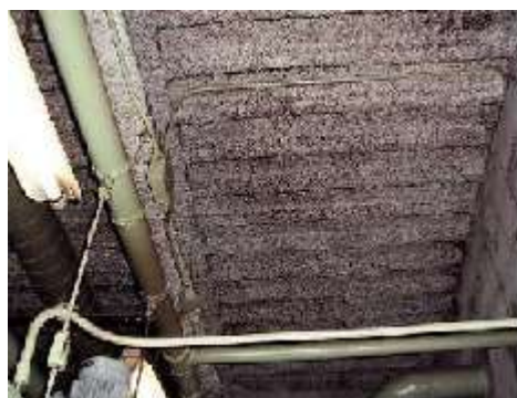
石綿含有吹付けロックウール
