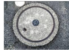
公共マス コンクリート製 (直径40~50cm)
