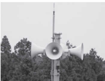
▲防災無線施設（上土田地内）
