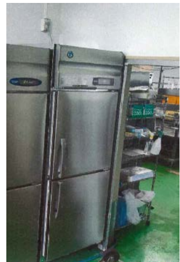
更新した調理設備 業務用冷蔵庫
