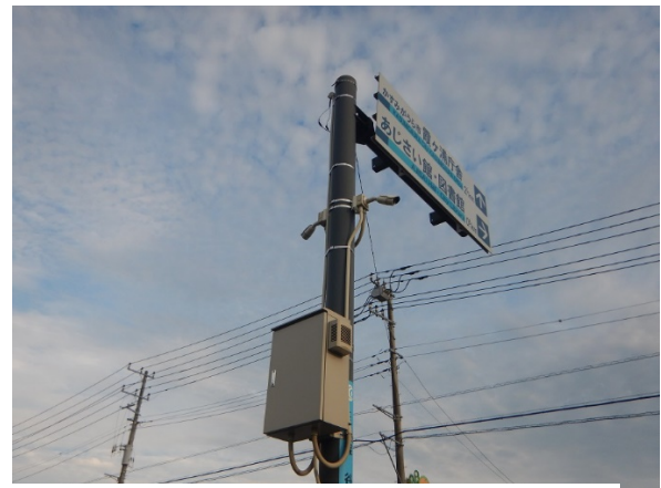
市内に設置されている防犯カメラ
