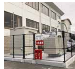
非常用発電機整備
