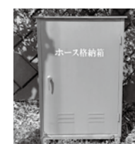
消火栓ホース格納箱
