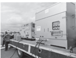
▲国交省手配の排水ポンプ
