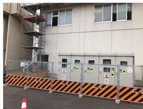
仮設受変電設備
