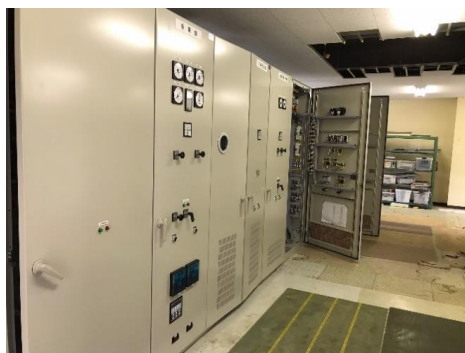
更新中の受変電設備
