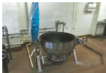
更新した調理設備 回転釜
