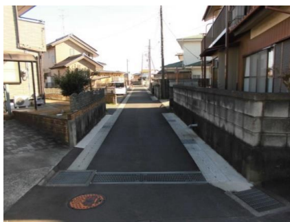
逆西排水区浸水箇所
