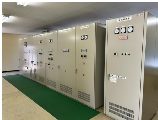
【霞ヶ浦浄水場】更新された受変電盤施設
