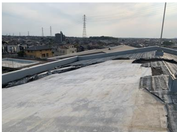
下稲吉東小学校屋根状況
