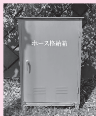
消火栓ホース格納箱
