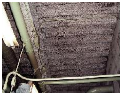
石綿含有吹付けロックウール
